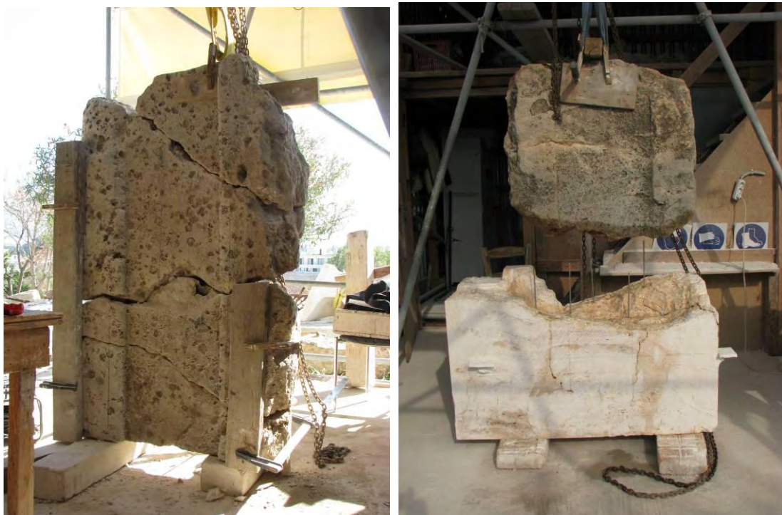
Εργασίες συγκόλλησης (αριστερά) και συμπλήρωσης (δεξιά) εδωλίων από την κεντρική κερκίδα του Θεάτρου
