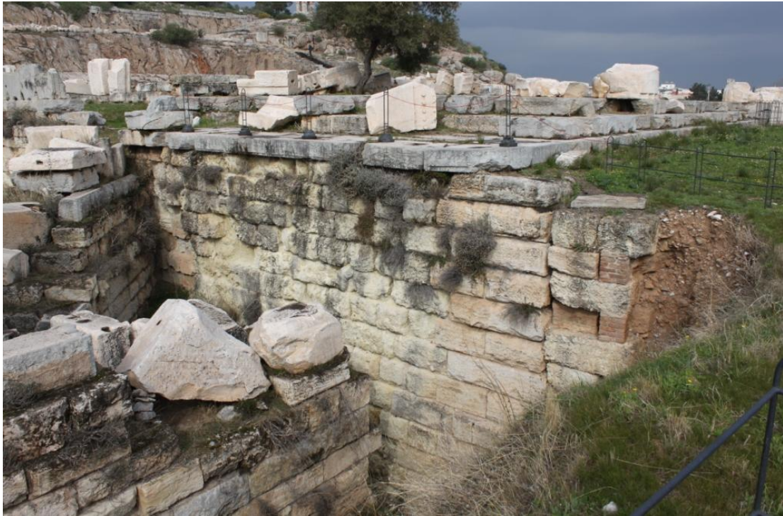
Εικ.16. Πώρινα θεμέλια της νοτιοδυτικής γωνίας του κτηρίου: Βιοδιάβρωση, αποσάθρωση των επιφανειών και απώλειες λίθων στα θεμέλια.
