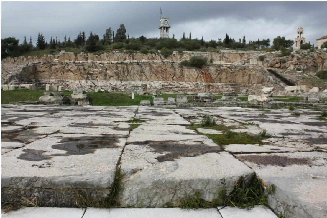
Εικ. 18. Η πλακόστρωση της στοάς το Φίλωνος από ελευσινιακό γκρίζο ασβεστόλιθο: διάνοιξη αρμών, θραύσεις και βιοδιάβρωση.
