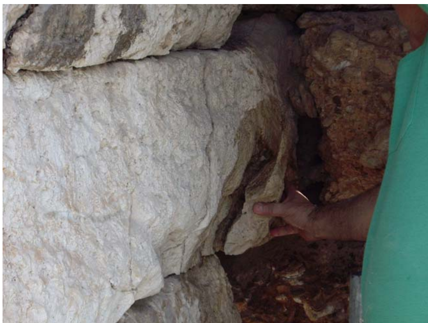
Εικόνα 10: Αποκολλημένο τμήμα στον λιθόπλινθο της γενέτειρας του τόξου..
