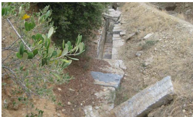
Ο αποχετευτικός αγωγός
