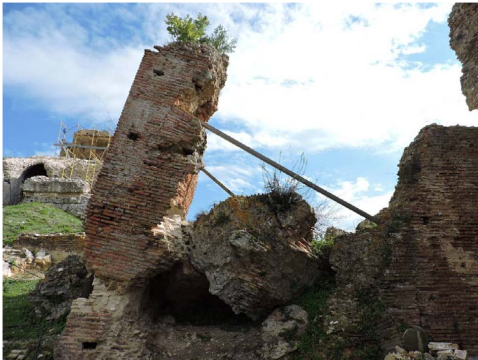
Εικ.12. Το θέατρο της Νικόπολης Αποψη της απόκλισης τμήματος τοίχου του σκηνικού οικοδομήματος.
