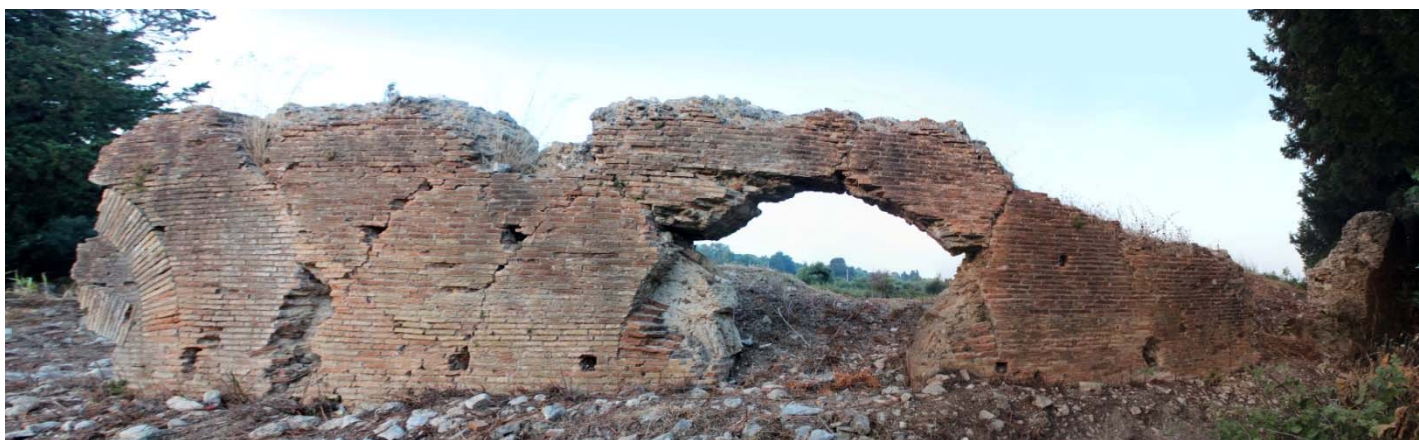
Εικόνες 8 και 9. Στη περίπτωση των κατασκευών που χρονολογούνται στη Β' φάση παρατηρούνται καταπτώσεις θόλων (πάνω), ανώτερων τμημάτων της ανωδομής και διακοπή της συνοχής των τοιχοποιιών λόγω διαμπερών ρωγμών (Αρχείο Επιστημονικής Επιτροπής Νικόπολης).
