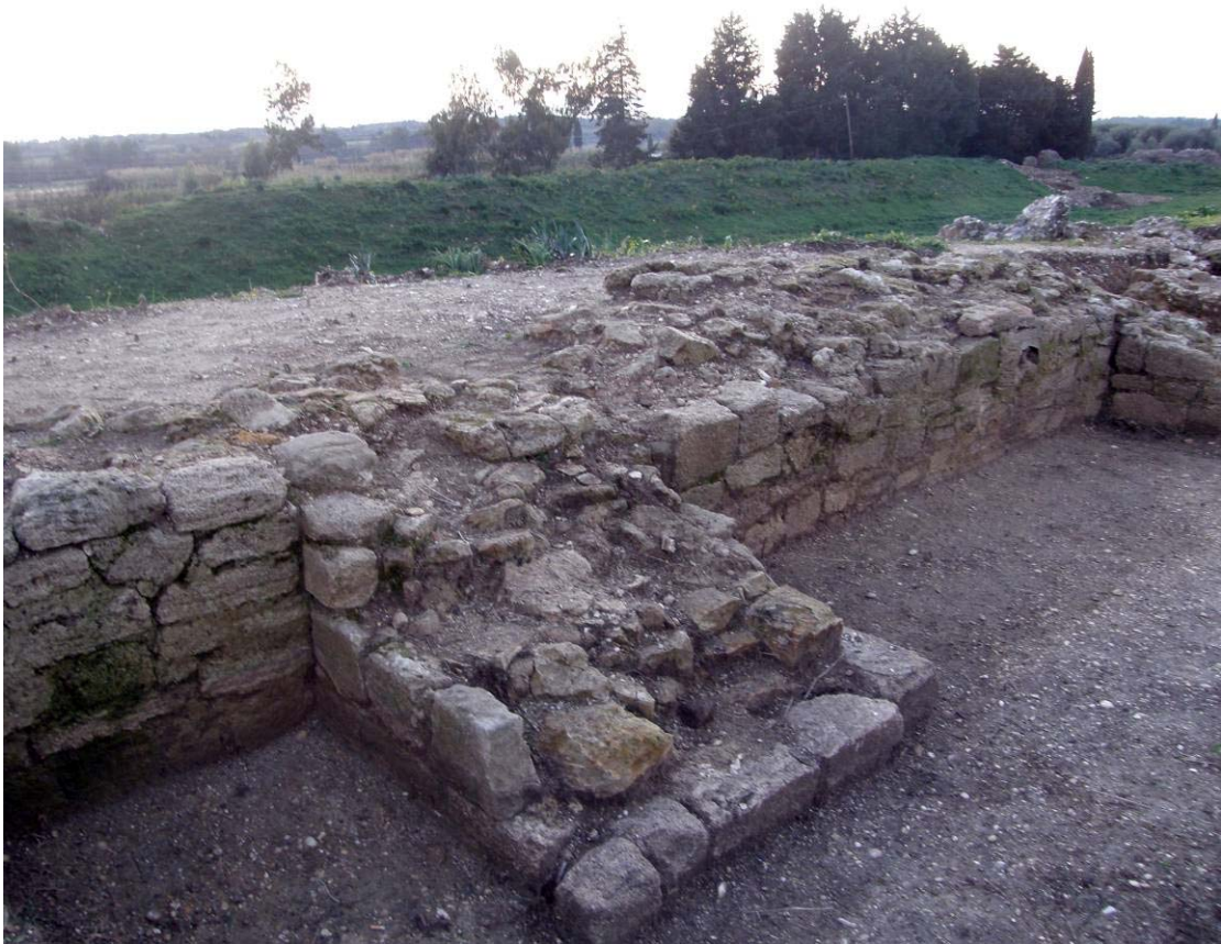
Εικόνα 7. Τμήμα του βόρειου αναλημματικού τοίχου. Διακρίνονται το είδος τοιχοποιίας και η χαρακτηριστική αποσάθρωση των κονιαμάτων της Α' φάσης (Zachos – Pavlidis 2010).
