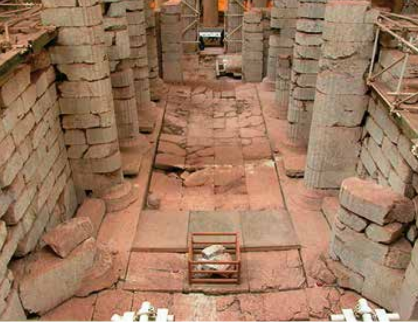
Εσωτερικό του ναού. Το στέγαστρο έχει ήδη τοποθετηθεί. Εργασίες αποκατάστασης. Πηγή: Υπουργείο Πολιτισμού.
