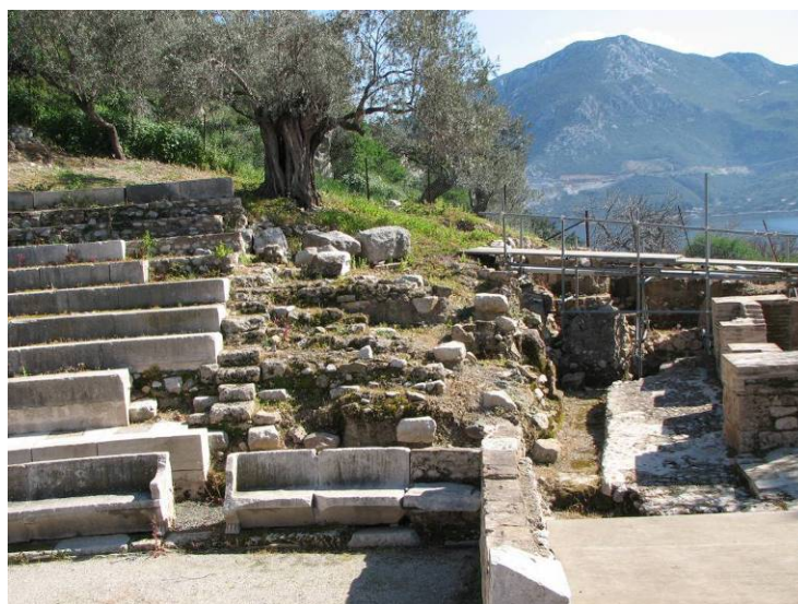
Η κατεστραμμένη ακραία κερκίδα Ι του θεάτρου, για την οποία απαιτείται στερέωση και συμπλήρωση των υποδομών των εδωλίων σε συνδυασμό με την συμπλήρωση του αναλήμματος.
