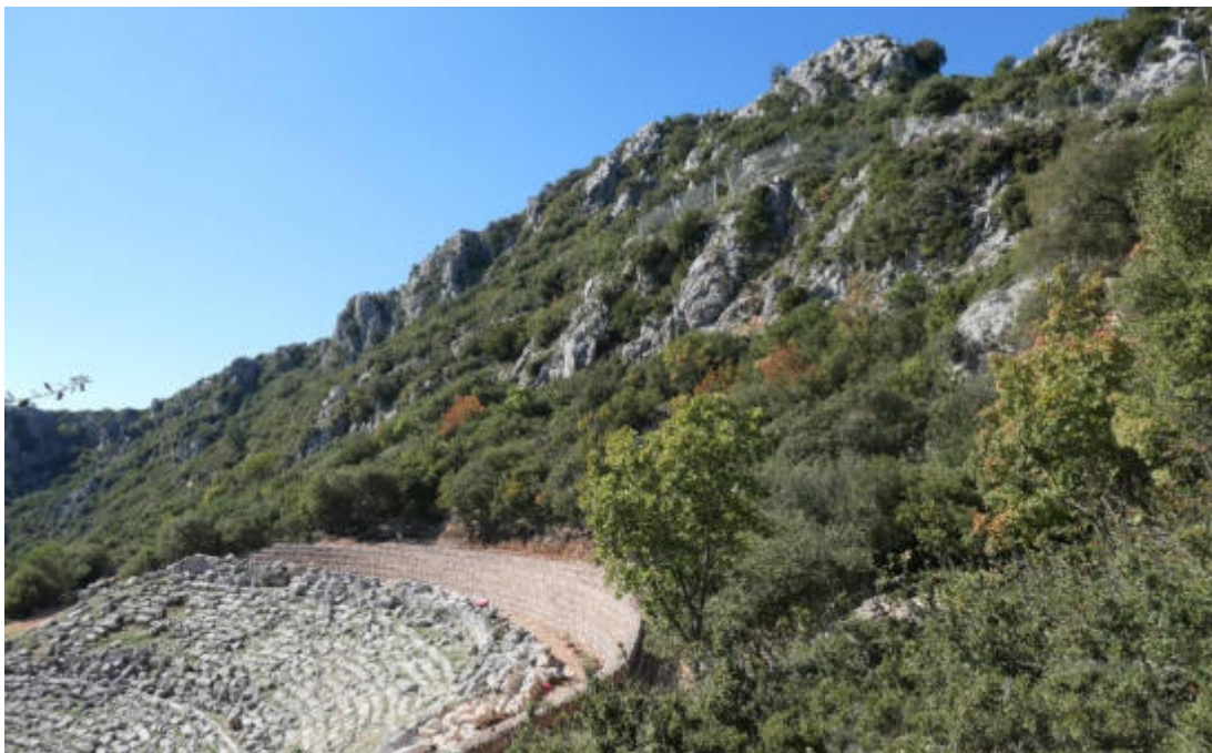
Εικόνα 5. Βραχοπαγίδα και φράκτες ανάσχεσης καταπτώσεων. Picture 5. Rock trap and rockfall retention fences.
