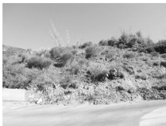
Η κατολίθωση από άλλη γωνία διακρίνονται τα καμένα-κομμένα δένδρα
